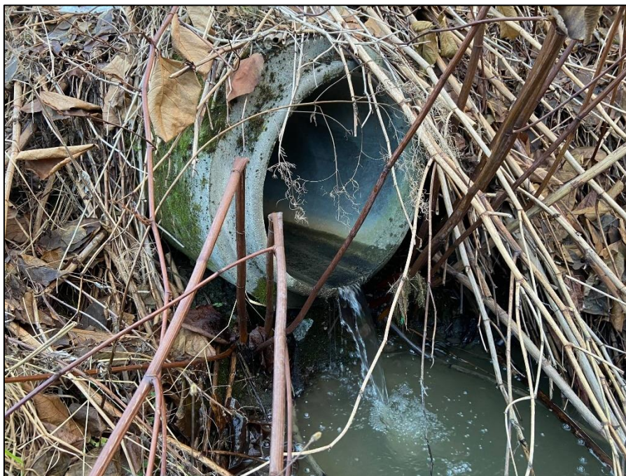
Figur 6: Utløp av kulvert ved Kaldvella. Kulverten fungerer som et vandringshinder for anadrom fisk..
